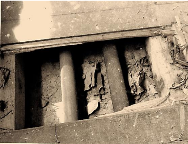
床下の配管（温水パイプ）
