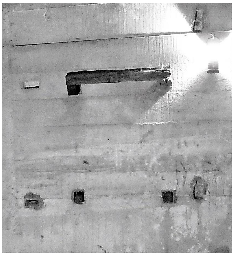
航空本部壕への分岐点の配電盤跡
