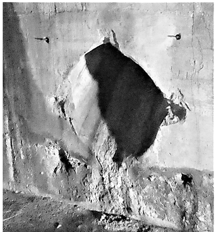
バッテリー室 横穴 換気扇跡
